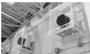
体育館に設置された空調設備
