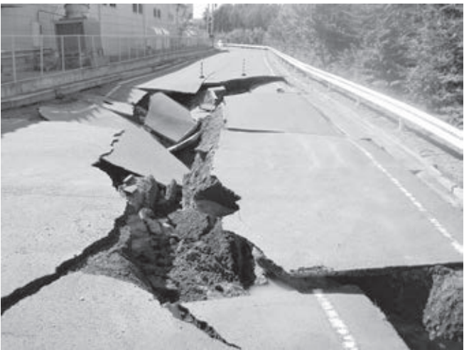
姉妹町・福島県矢吹町の被害の状況
