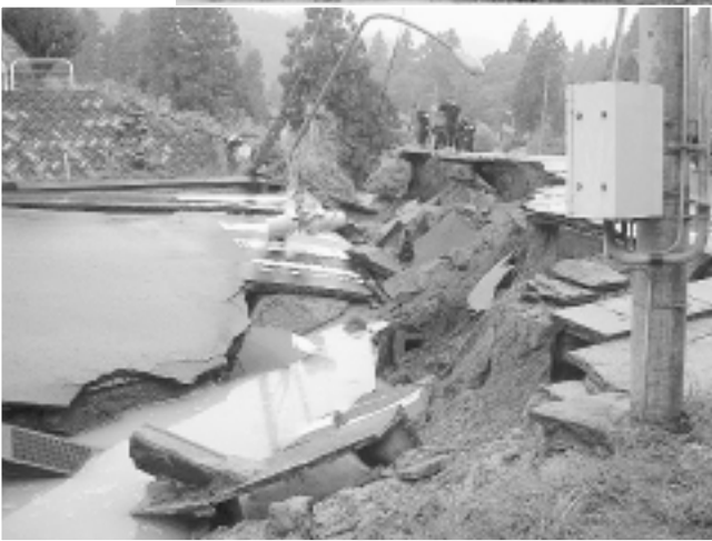
甚大な道路被害(栃尾市内の国道)
