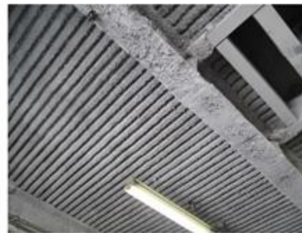
天井に吹き付けられたアスベスト
