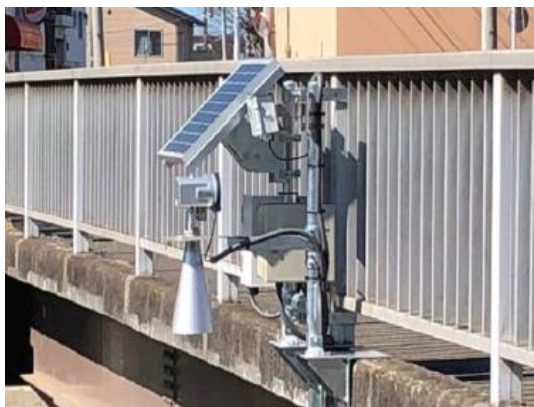
■水位計・簡易型河川監視カメラ
