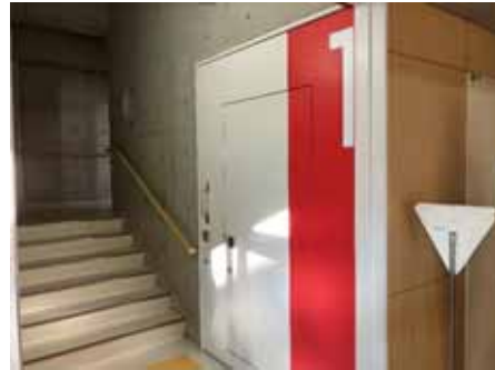
防火扉 (右:止まれ看板)
