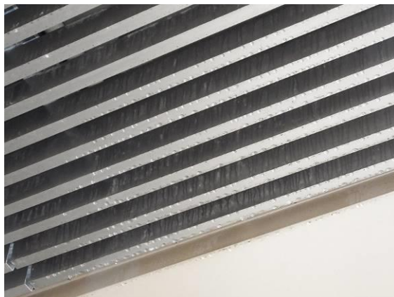
写真 2-4 デッキ外面の雨漏り跡状況写真
