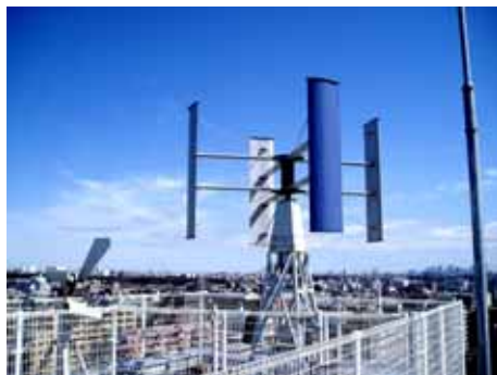
屋上に設置された風力発電装置
