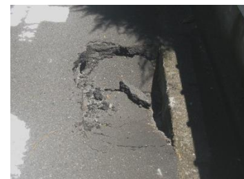
■道路陥没の事例
