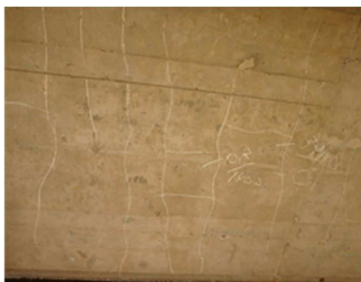
写真 4-3 床版損傷（泉橋）
