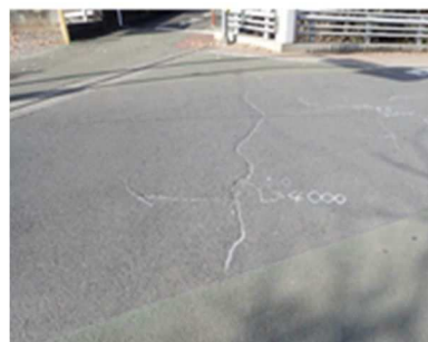
写真 4-9 舗装損傷（井の頭橋）
