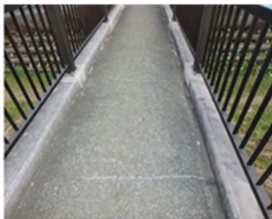
写真 4-8 舗装損傷（榛沢橋）
