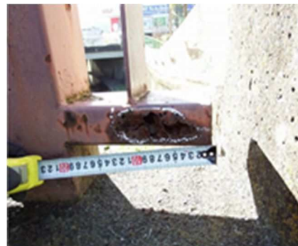
写真 4-13 高欄・防護柵損傷（長久保二之橋）
