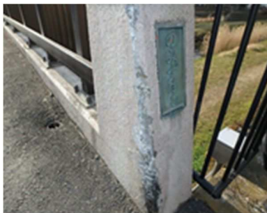
写真 4-10 地覆損傷（野水橋）
