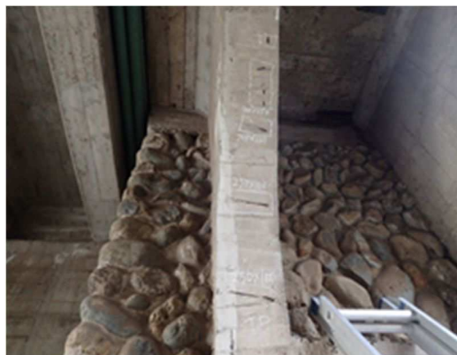
写真 4-5 上部工損傷（宮下橋）
