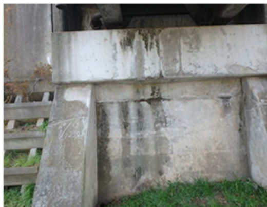
写真 4-7 下部工損傷（清水橋）
