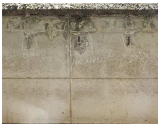
写真 4-4 床版損傷（勝洲橋）
