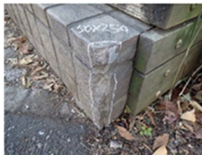
写真 4-11 地覆損傷（東橋）
