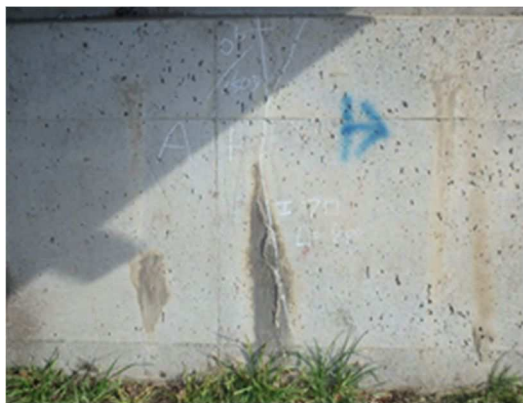
写真 4-6 下部工損傷（八幡橋）
