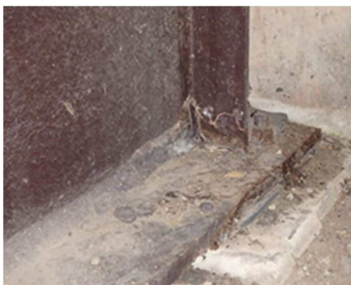
写真 4-1 塗装劣化（泉橋）
