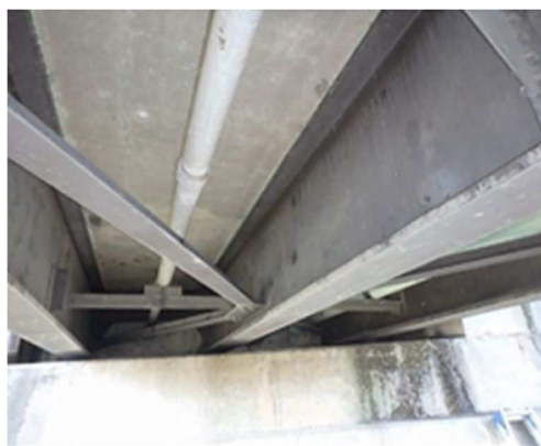
写真 4-2 塗装劣化（八幡橋）
