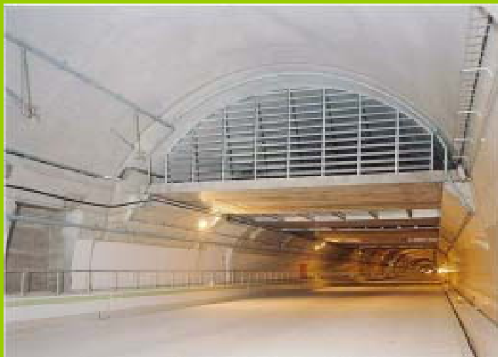
神戸淡路鳴門自動車道 舞子トンネル 電気集じん機室(天井設置型) 送気口
