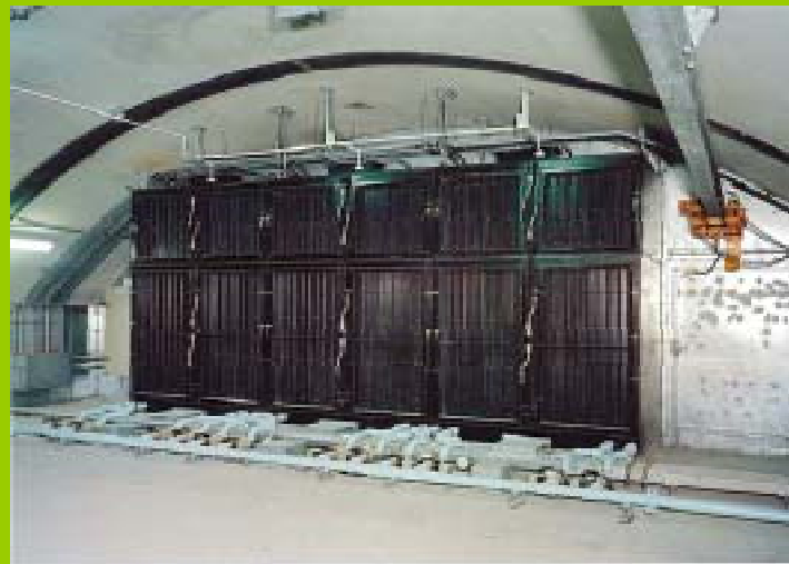
神戸淡路鳴門自動車道 舞子トンネル 電気集じん機室(天井設置型) 集じん機
