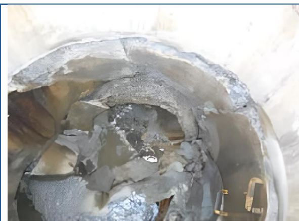
下水道管の破損(接合部)
