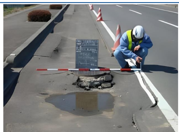
栃木県大田原市入孔突出、路面異常
