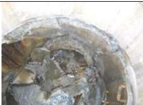
下水道管の破損
