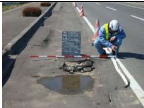
栃木県大田原市入孔突出、路面異常
