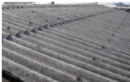
アスベスト含有スレート（波板）
