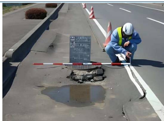
栃木県大田原市入孔突出、路面異常
