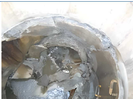
下水道管の破損(接合部)
