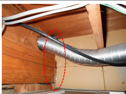
①1階浴室天井裏(東側住戸) 準耐火構造であるか不明である。
