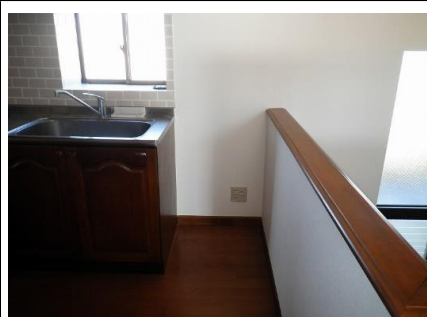
①2階廊下(西側住戸) 給気口が未設置
