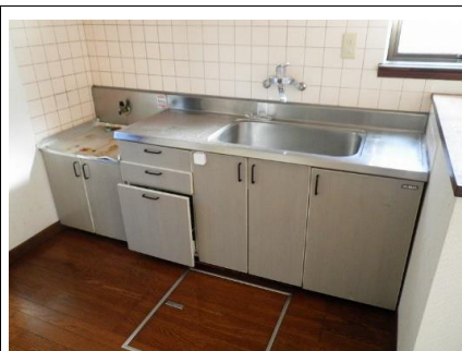
1階台所(東側住戸) 流し台
