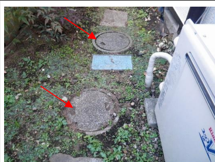
北側外構 汚水枳
