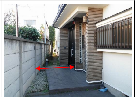
②敷地北側の敷地内の通路 幅員が不足していた。
