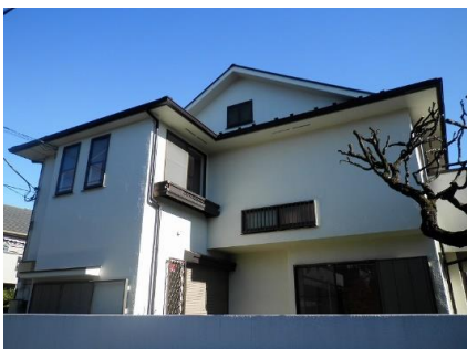
①西側外壁面 防火設備が未設置
