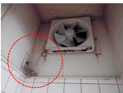
①1階台所(東側住戸) 可燃物が設置されていた。
