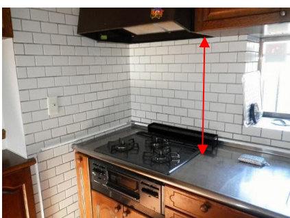
②1階食堂台所(西側住戸) 離隔距離が不足していた
